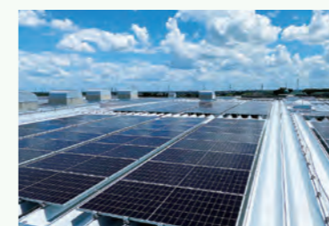
屋根上の太陽光パネル
