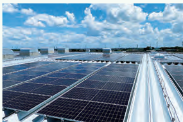
屋根上の太陽光パネル
