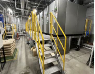
かさ上げされた羽島工場の設備
