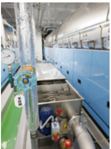
洗濯排水熱交換器
