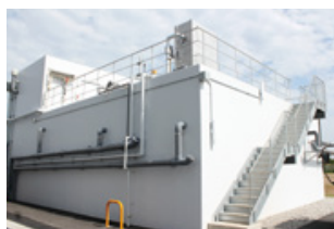
排水リサイクル設備
